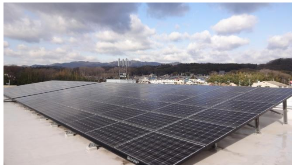
市内の事業所が設置した太陽光発電システム
